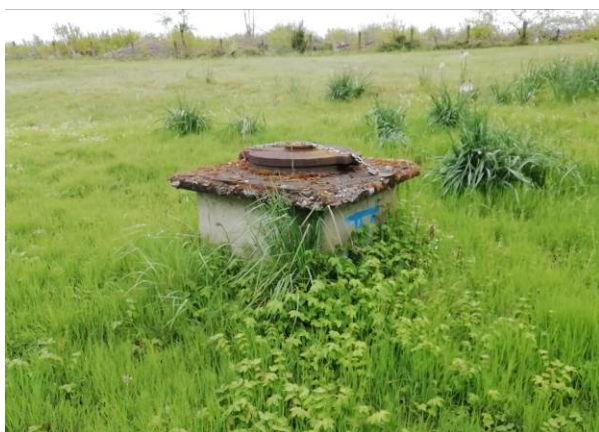
Photo n°8 : Vue extérieure du regard de visite
